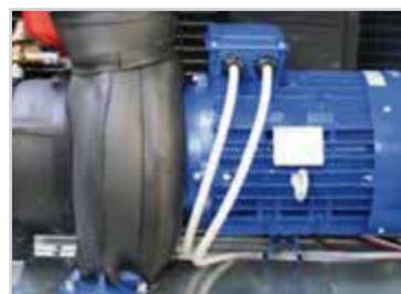
Bomba de agua de caudal variable.
