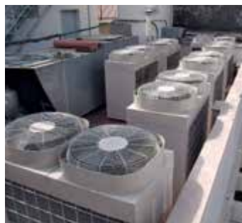
Hotel Dimar, Valencia Sistema de caudal variable
